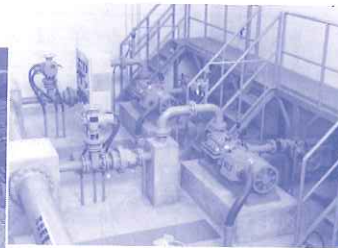
運転開始をまつポンプ
