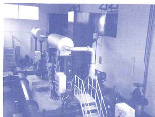
ポンプ施設(手前かん水用・後方凍霜害用)
