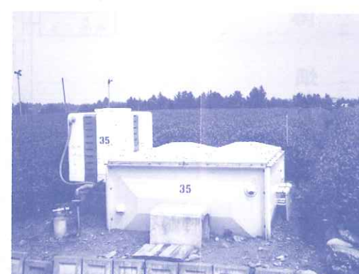
混入器と薬液稀释槽
